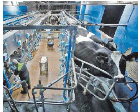
Unha moderna instalación de muxidoiras de Lugo. Foto: Óscar Cela
